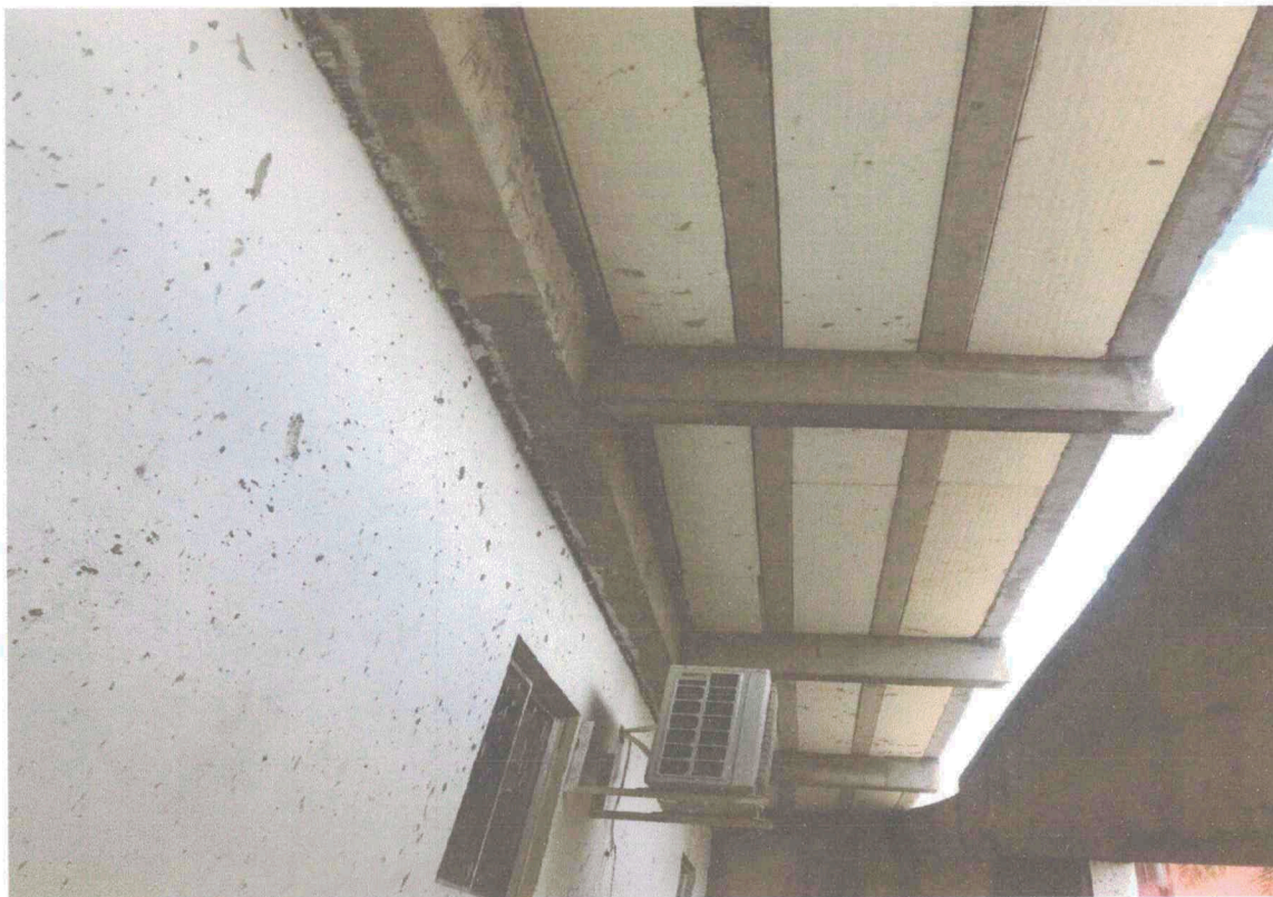
Foto 05: Laje da passarela causando flexão sobre a viga sem sustentação.
