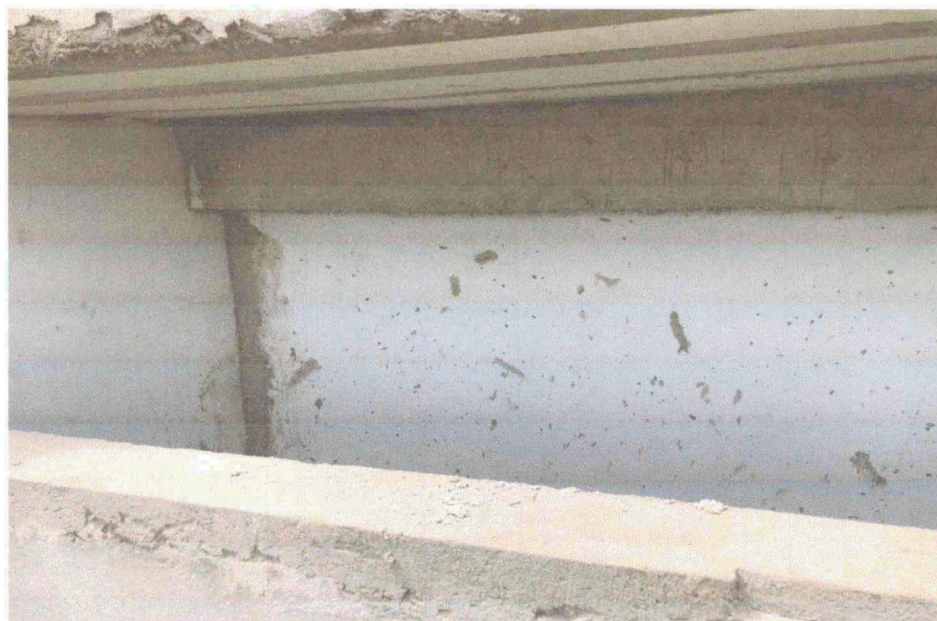
Foto 01: Desplacamento da viga sem sustentação da propria laje, e da parede externa do prédio principal
