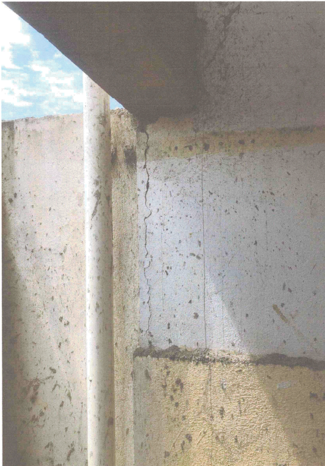
Foto 03: Estrutura causando fissuras e trincas na parede de alvenaria, pois não há sustentação estrutural para suportar as cargas.
