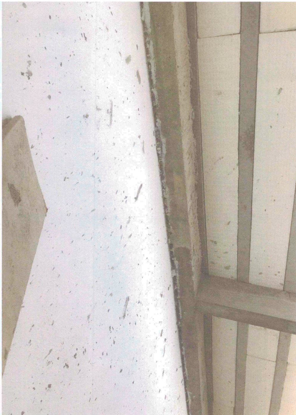
Foto 09: Trincas e ferrugem na viga devido a flexão causada pelas cargas atuantes na estrutura.
