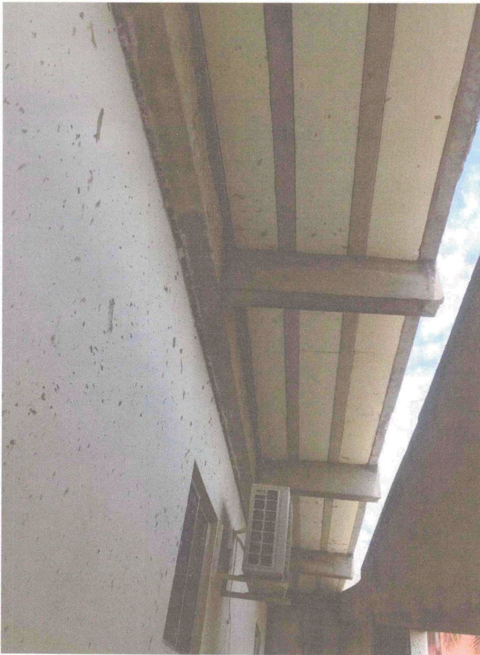
Foto07: Deslocamento de viga em parede sem devida estrutura de suporte.
